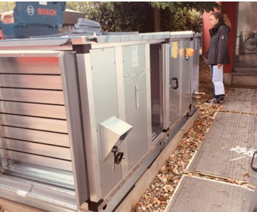
Lüftungsgerät, im Vordergrund: Außenluftansaugung
